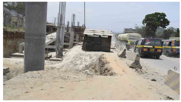
Figure 4: Préoccupations en matière de gestion du site de construction de la passerelle pour piétons (excavation non sécurisée)
