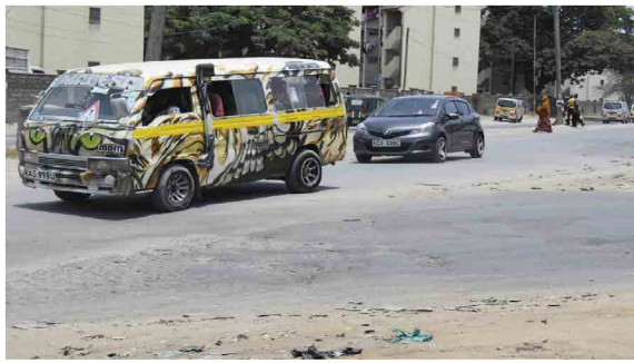
Figure 2: Revêtement la chaussée détériorée à l'intersection de Makande
