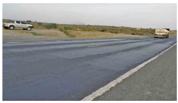
Figure 10: Ressuage du revêtement de la route
