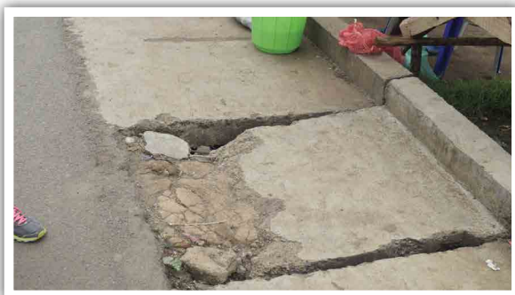
Figure 31: Dalle endommagée couvrant le drainage et d'eaux pluviales
