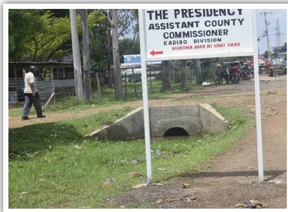
Figure 30: Ponceau d'accès bloqué
