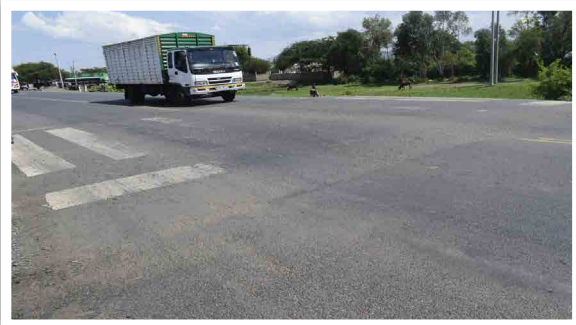
Figure 26: Les marquages routiers au passage piétonnier se sont estompés
