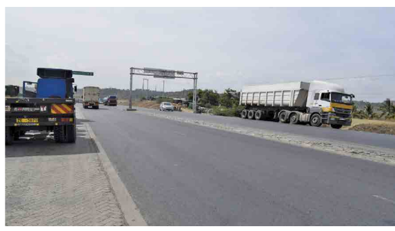
Figure 7: Marquages de la route estompés
