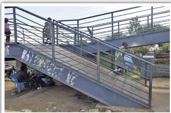
Figure 33: Une rampe anormalement raide sur une passerelle piétonnière
