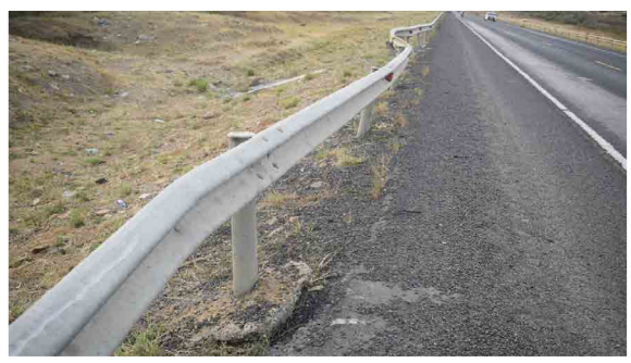
Figure 12: Glissières de sécurité endommagées
