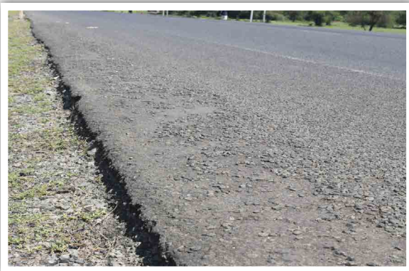
Figure 27: Les accotements sont suspendus
